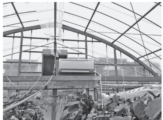
図-1 ヒートポンプ空調機の設置状況
