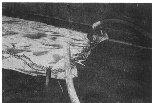
第6図 土壌蒸気消毒(耕起後消毒管を埋没、カバーシートで覆い、チェーンで周囲をおさえる)
