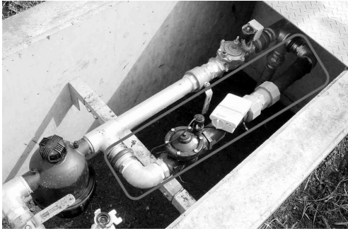
図-9 取りはずしが可能な散水制御装置
