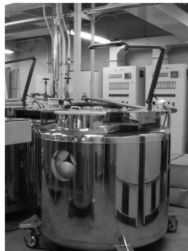
図-4 液体窒素タンクとその制御盤
